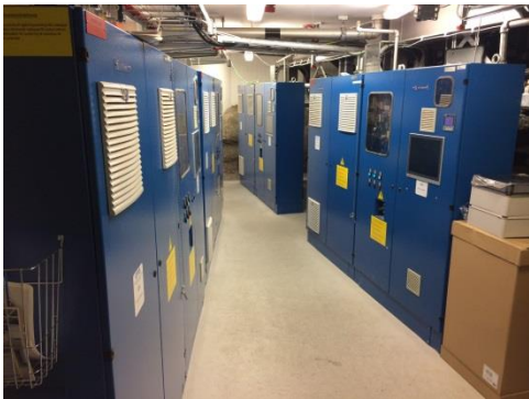
Figur 7: Apparatskåp och sprinkler
