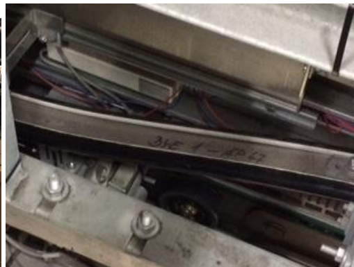
Figur 8: Kabeldragning i stomme
